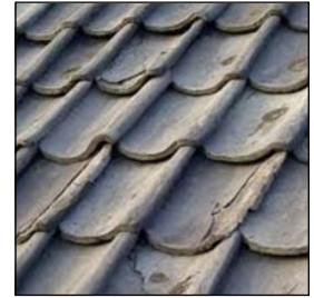
Matige tot slechte staat: dakpan met schilfers en gescheurde pannen
