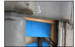
Punt waar water onder de folie kan komen
